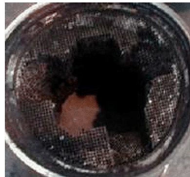
Omfattende indvendig skade
