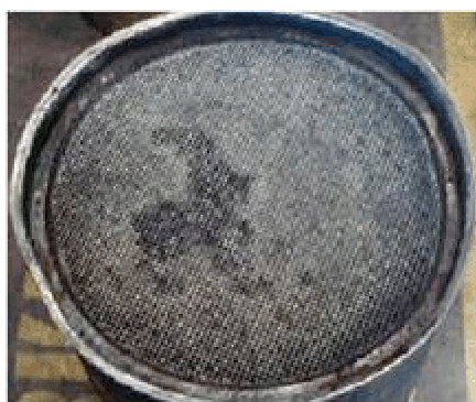
Lokal indvendig skade
