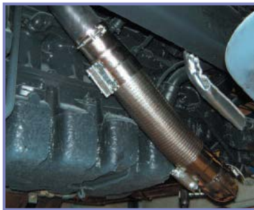
Figur 18 - Typisk flexrør, som beskytter mod vibrationer
